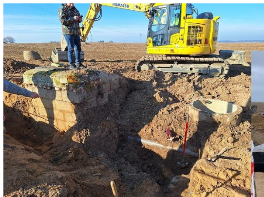
Armaturní šachta a přivaděč u VDJ Krymlov.
